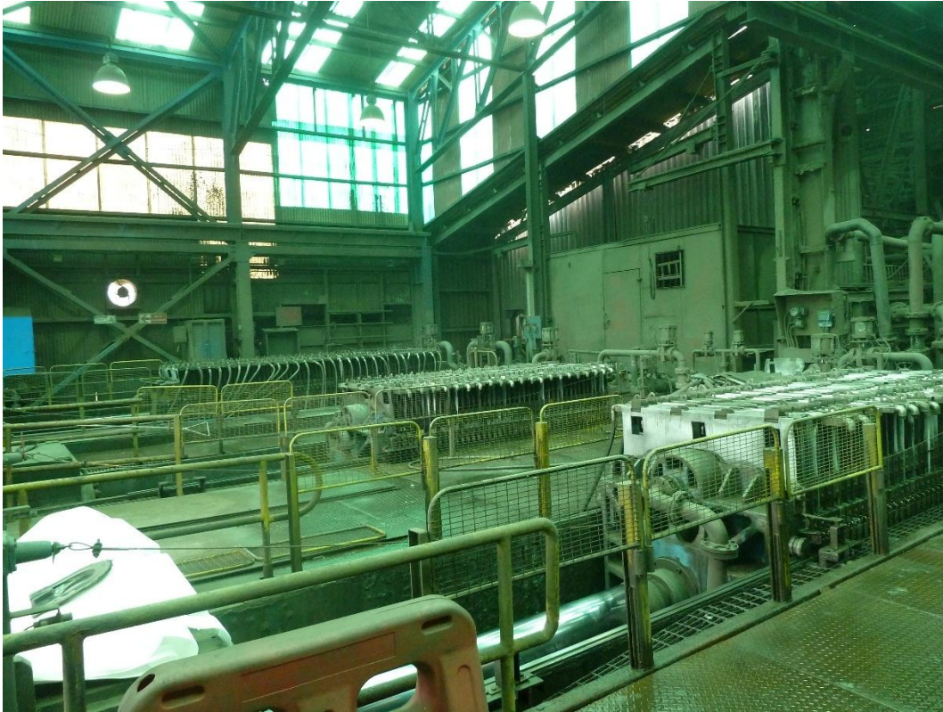
Figura N° 35: Fotografía de los Filtros LASTA
