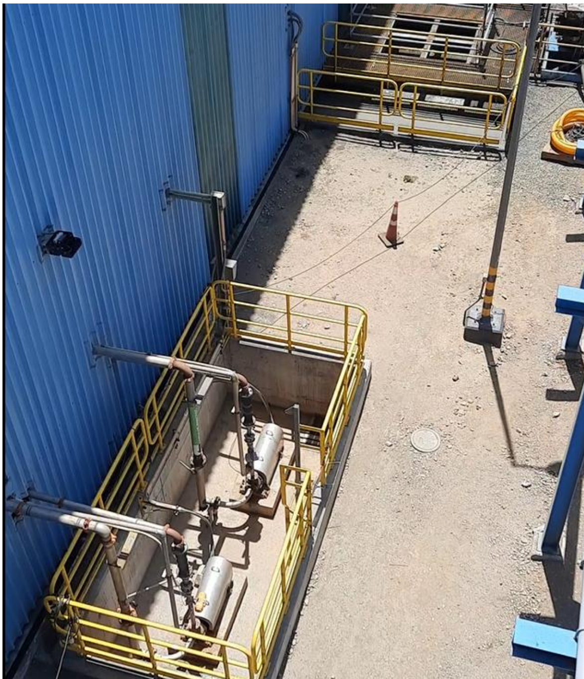
Figura N° 11: Fotografía de dos Bombas de Filtrado instaladas en un foso en Punta Chungo
