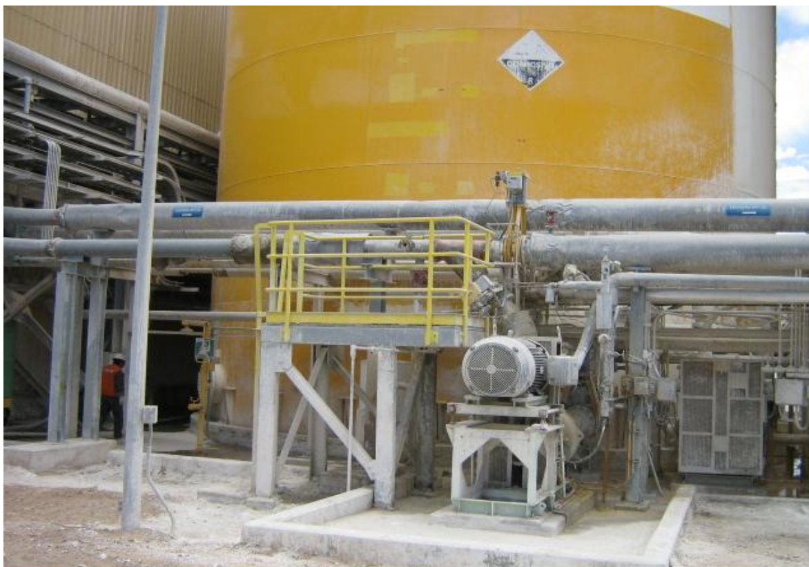
Figura 40: Estanque de Almacenamiento de Lechada de Cal de una Minera en Chile
